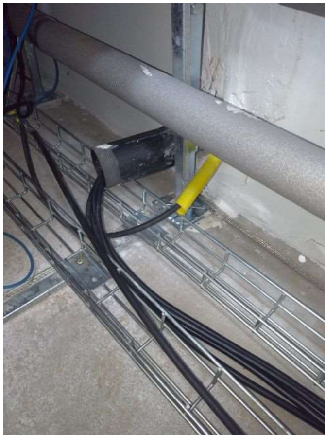
Figura 4 - Cabos sob o piso elevado
